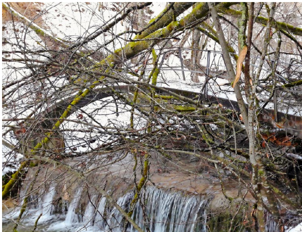
Der harsche Wintersturm (Bild vom 19. Januar 2021) hat den Waldbäumen im Küssnacher Tobel arg zugesetzt, so auch hier beim «Seufzerbrücklein» oberhalb des Alexandersteins. Die abgebildete Brücke hielt den enormen Belastungen nicht stand und musste repariert werden. Foto: Irene Jungwirth.
