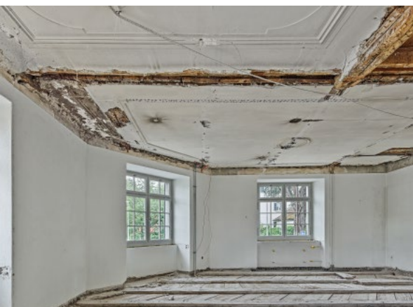
Abb. 6: Während des Umbaus 2022 wurden die historischen, mit Stuckprofilen versehenen Decken entdeckt. Foto: Roger Frei, Zürich
